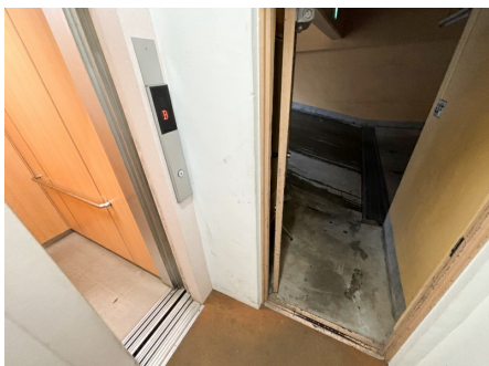
エレベーター
