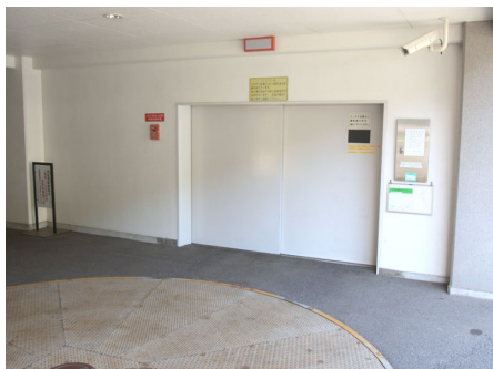
機械式駐車場
