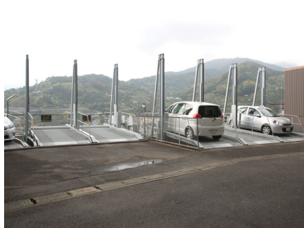
機械式駐車場
