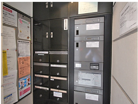
宅配ボックス
