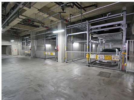
機械式駐車場
