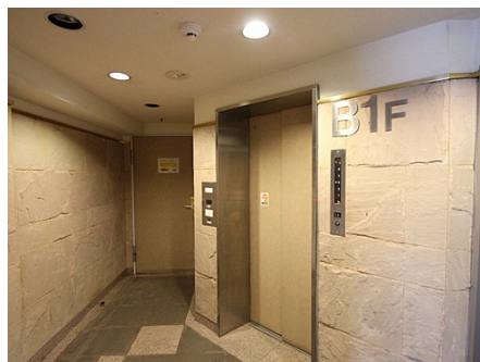
エレベーター
