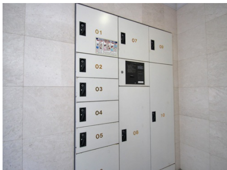
宅配ボックス
