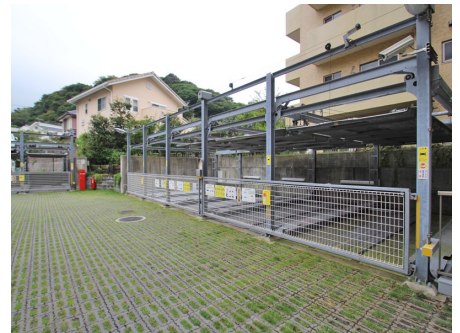
機械式駐車場
