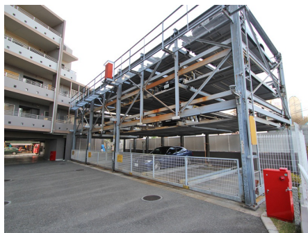
機械式駐車場
