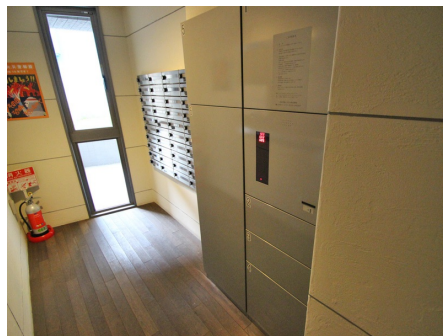
宅配ボックス
