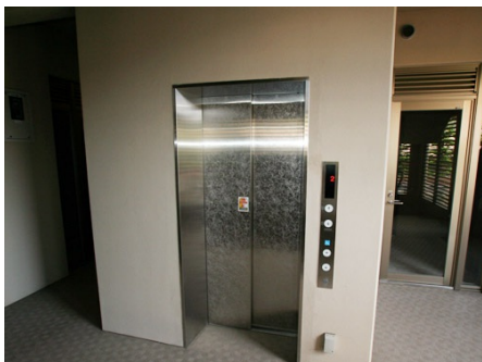
エレベーター
