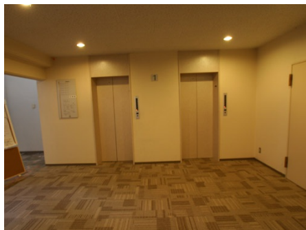
エレベーター
