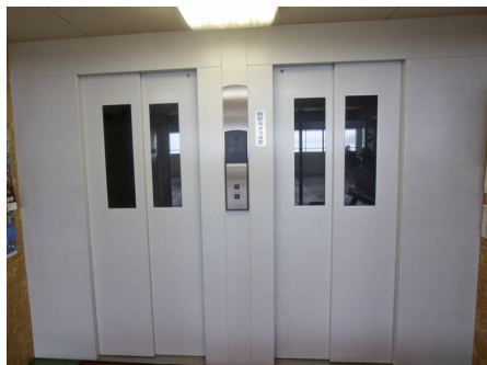
エレベーター2基
