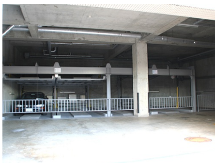
機械式駐車場
