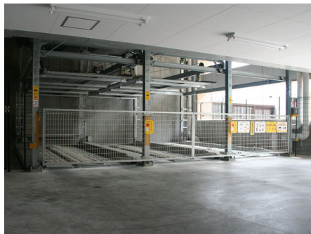
機械式駐車場
